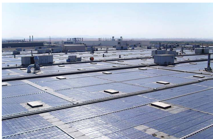
Fotografía 6.2-2. Instalación fotovoltaica sobre cubierta de 10MW (Zaragoza)
