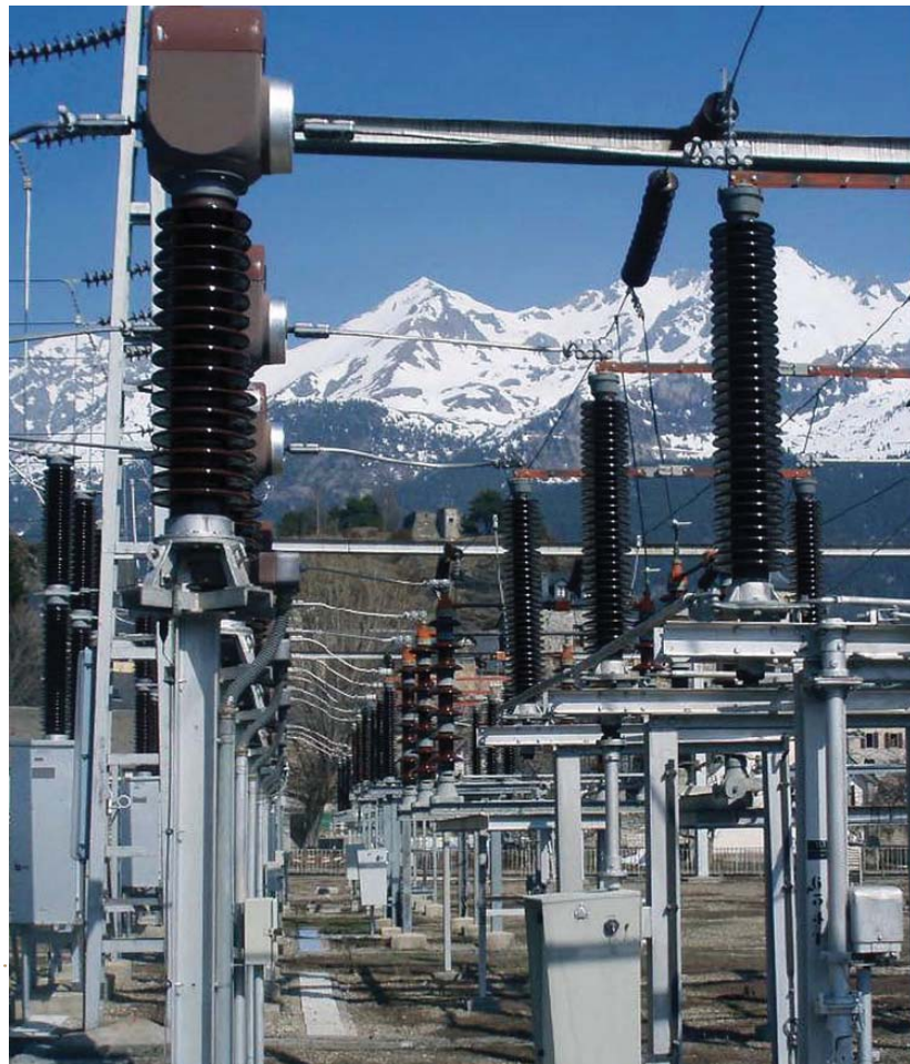
Fotografía 10.4-4. SET Central hidroeléctrica Sallent (Sallent de Gállego, Huesca)
