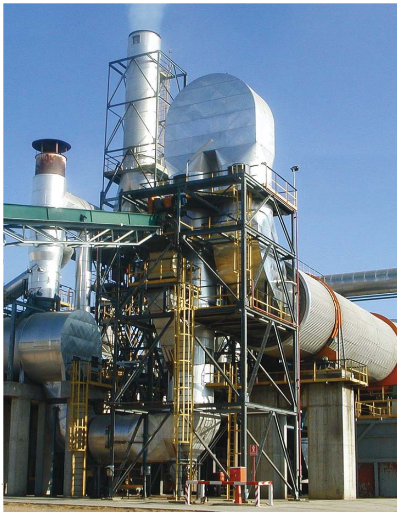
Fotografía 9.3-2. Central de cogeneración de 24,9MW (Cella, Teruel)
