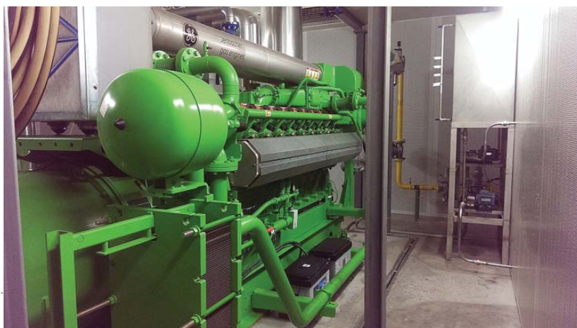
Fotografía 8.2-1. Central de trigeneración de 1MW (Mallén,Zaragoza)
