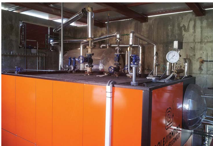
Fotografía 5.2-3. Caldera vapor con biomasa, 1.395 kW (Villamayor, Zaragoza)
