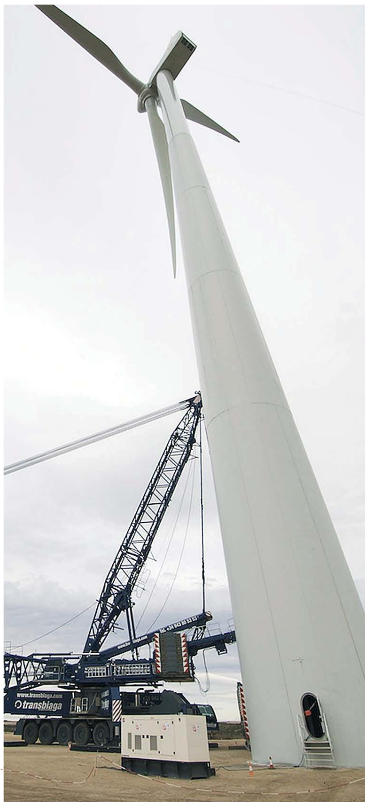
Fotografía 12.2-1. Parque eólico I+D de 4,5 MW (Jaulín, Zaragoza)
