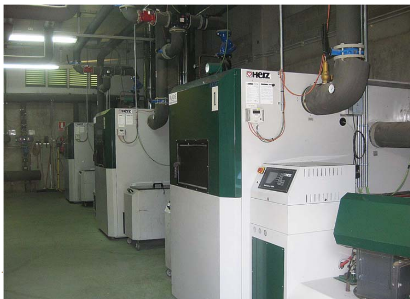
Fotografía 7.2-1. Calderas biomasa 3x500 kW (Alagón, Zaragoza)
