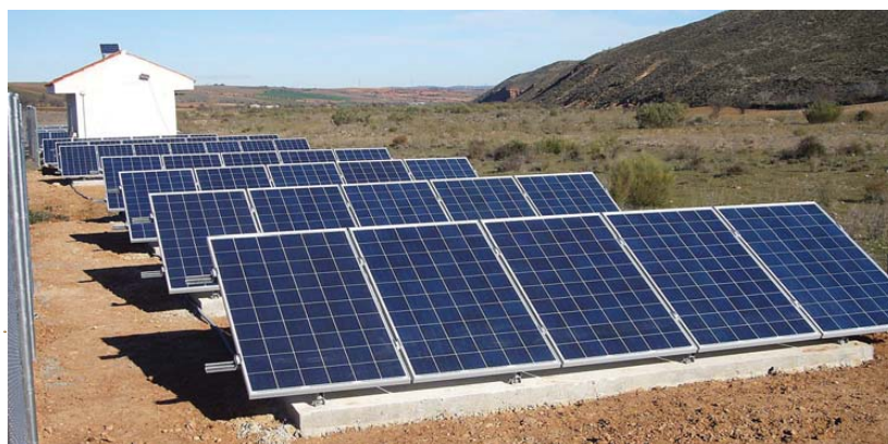
Fotografía 15.3-2. Instalación solar de 14,2 kW para abastecimiento de agua (Villar de los Navarros, Zaragoza)
