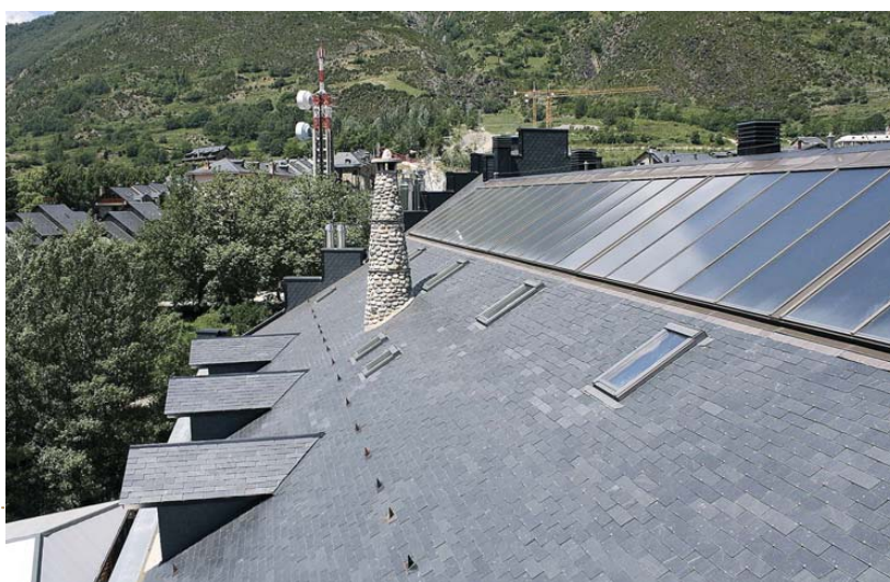
Fotografía 14.1-1. Instalación solar térmica de 63,61kW (Benasque, Huesca)
