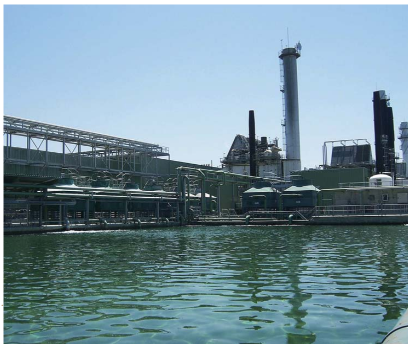
Fotografía 9.3-4. Planta de cogeneración de biogás de 7,5 MW (Zaragoza)
